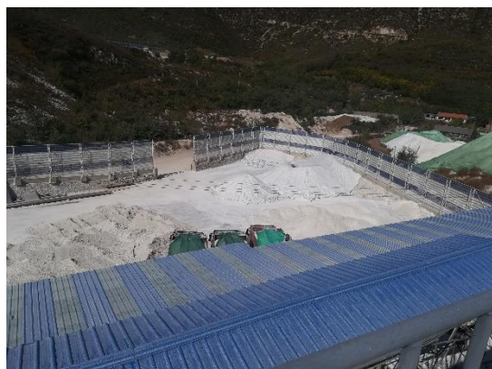
工业场地内防风抑尘网
